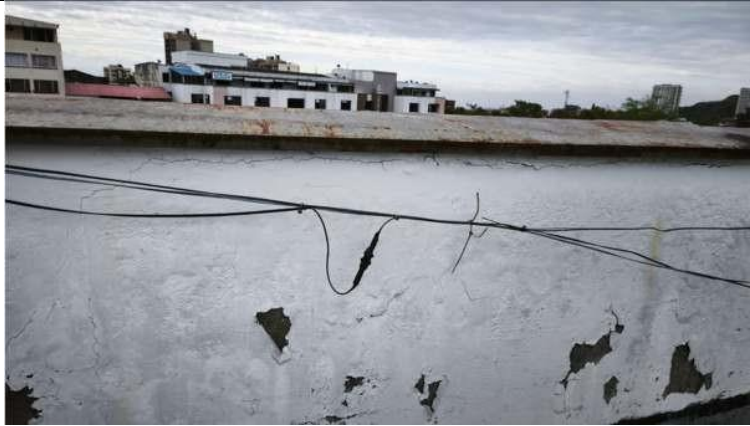
Antepechos en cubierta fisurados
