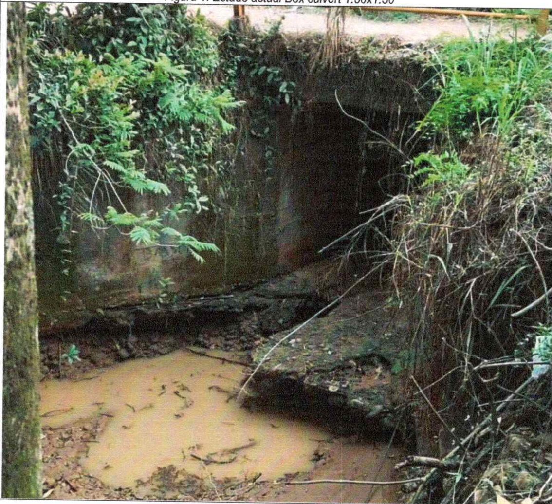
Perdida parcial de la Solera de descole
