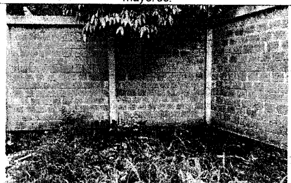
Imagen No 4. Fachada posterior, patio. Sin placa de piso, suelo no uniforme, ni plano, inadecuado para el tránsito de personas mayores. Muros sin pañete, estuco y pintura.
