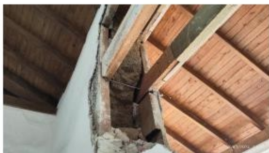
Muro afectado. Se observa antigua intervención de restauración adelantada con las técnicas ad hoc por el AMVA..
