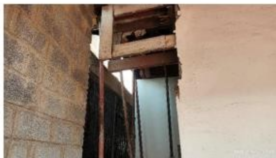
Muro afectado se encontraba en traba con el muro medianero, el cual ya no existe por lo que perdió parte de su estabilidad estructural.
