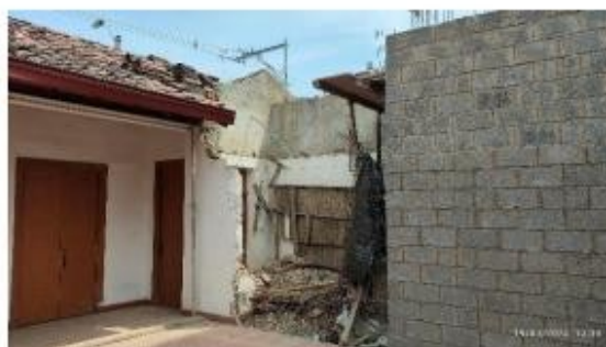
Zona con afectación total y muro que pretende reponer el medianero colpasado pero que sin embaego, no cumple con las características técnicas exigibles para la restauración de un BIC.
