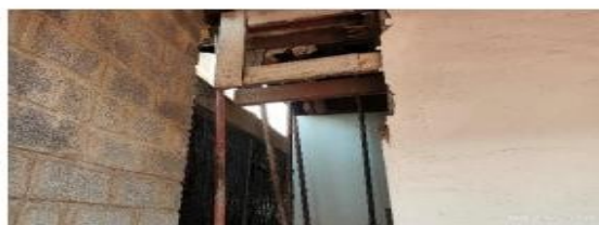
Muro afectado se encontraba en traba con el muro medianero, el cual ya no existe por lo que perdió parte de su estabilidad estructural.
