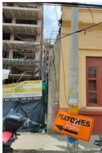
Muro colindante colapsado entre la casa de la cultura y el edificio el Zafiro
