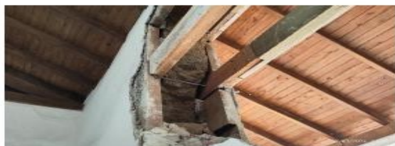
Muro afectado. Se observa antigua intervención de restauración adelantada con las técnicas ad hoc por el AMVA..
