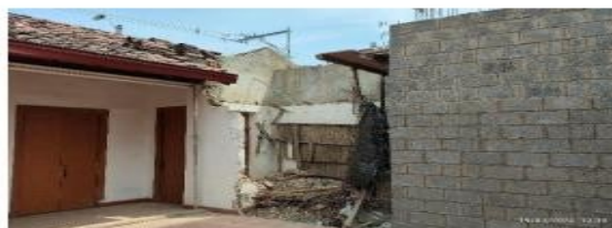
Zona con afectación total y muro que pretende reponer el medianero colapsado pero que sin embargo, no cumple con las características técnicas exigibles para la restauración de un BIC.
