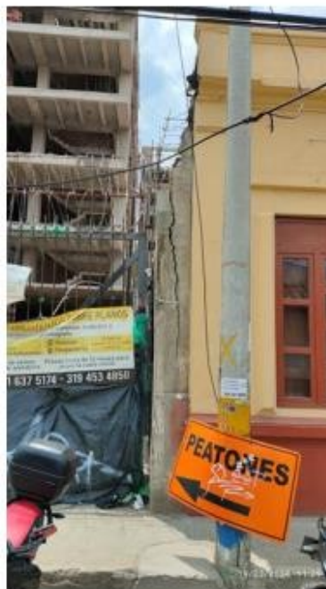
Muro colindante colapsado entre la casa de la cultura y el edificio el Zafiro
