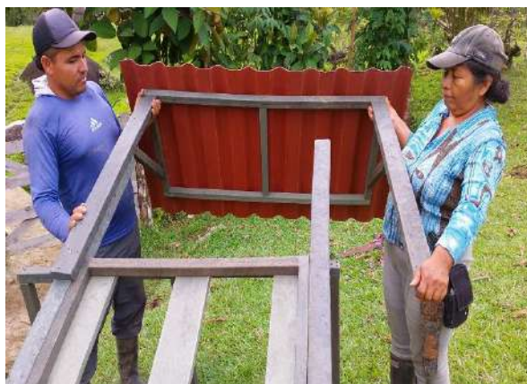
SUMINISTRO Y TRANSPORTE
