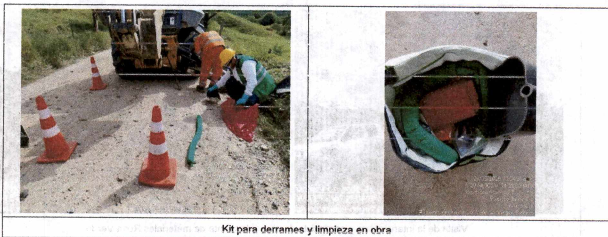
Ilustración 6. Limpieza de derrame de aceite hidráulico
