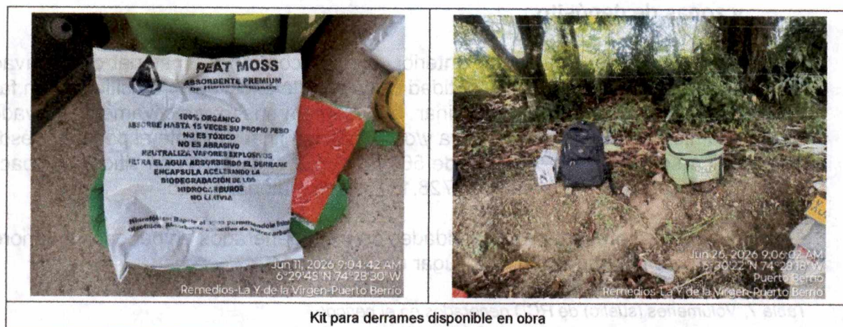
Ilustración 5. Limpieza de derrame de aceite hidráulico
