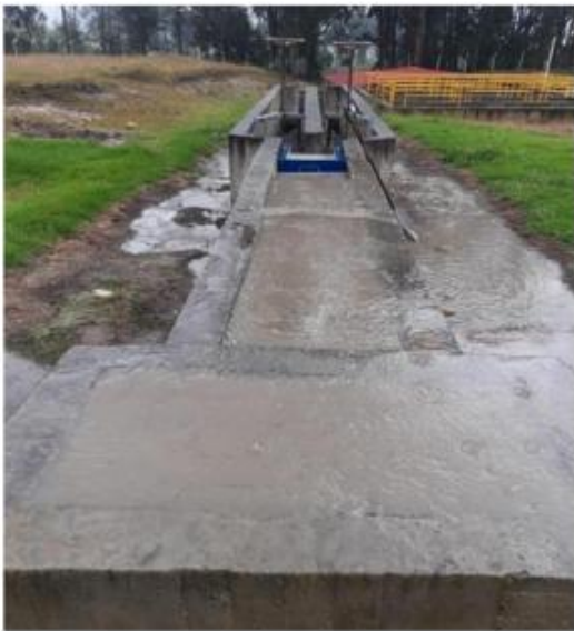
Foto 1. Obra de Llegada.
