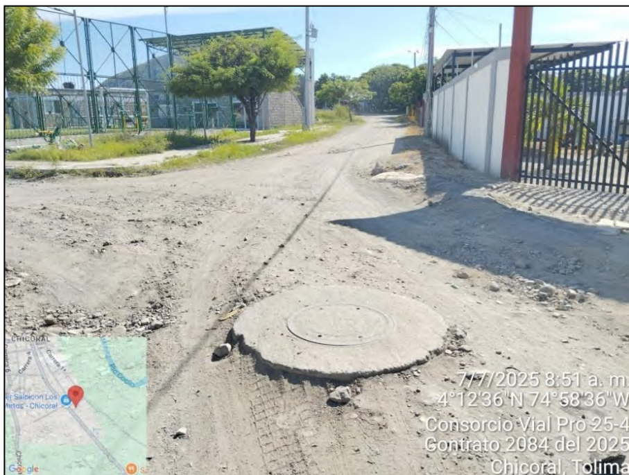
Fotografía 2. Estado inicial del TRAMO 36. Barrio Villa Inés Calle 3 sur (calle 1) entre carrera 1 y 2.
