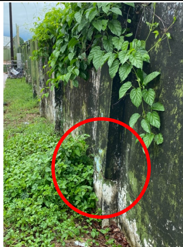
Cerramiento sobre la Calle 37, Vista interna, tramo de 40,00 m aproximados en riesgo de colapso, se muestra, grietas en el cuerpo del muro y volcamiento
