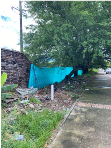
Sector colapsado del muro de cerramiento sobre la carrera 23. Vista desde el exterior.
