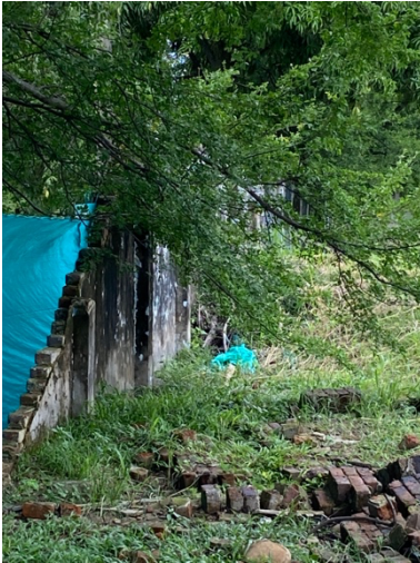
Tramo de cerramiento sobre la Carrera 23. Vista interna, Tramo colapsado, el muro que se encuentra en pie presenta desplome y alto riesgo de colapso.
