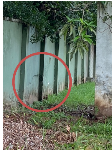
Tramo de cerramiento sobre la Carrera 23. Vista interna, zona cercana a canchas de tenis. Evidencia fisuras en el muro y las columnas de ladrillo. El muro presenta desplome respecto a la vertical. Alto riesgo de colapso.
