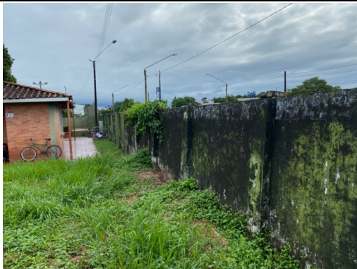
Cerramiento sobre la Calle 37, Vista interna, tramo de 40,00 m aproximados en riesgo de colapso, se muestra, grietas en el cuerpo del muro y volcamiento.
