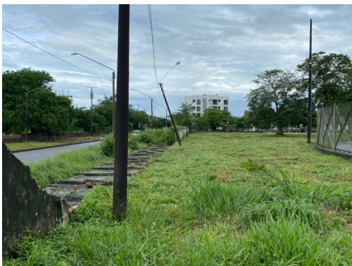
Cerramiento sobre la Calle 37, colapso de 60,00 ml de muro en mampostería. Vista interna.
