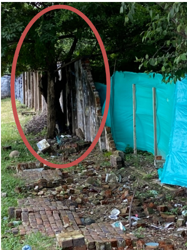
Tramo de cerramiento sobre la Carrera 23. Vista interna, Sitio de cerramiento colapsado, se evidencia la presencia de árbol que inciden negativamente en la estabilidad del cerramiento, la misma situación se presenta en varios puntos.
