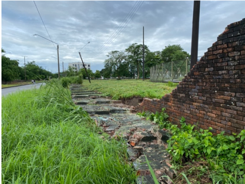
Cerramiento sobre la Calle 37, colapso de 60,00 ml de muro en mampostería.
