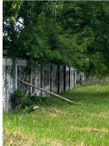
Tramo de cerramiento sobre la Carrera 23. Vista interna, Tramo siguiente al punto de colapso existente, muro que se encuentra en pie presenta desplome y alto riesgo de colapso.
