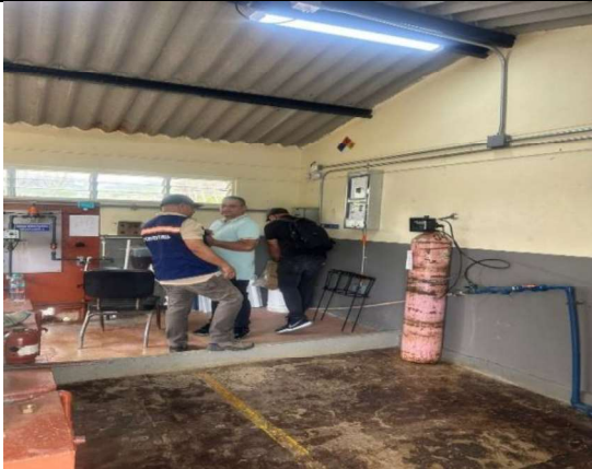
Revisión señalización parte eléctrica
