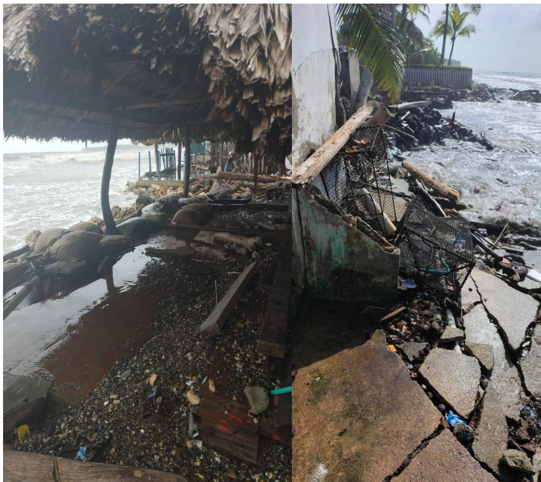
Figura 13 y 14. Afectaciones generadas en el sector de Santander de la Cruz, ante el aceleramiento de la erosión costera. Fuente: Alcaldía municipal de Moñitos.
