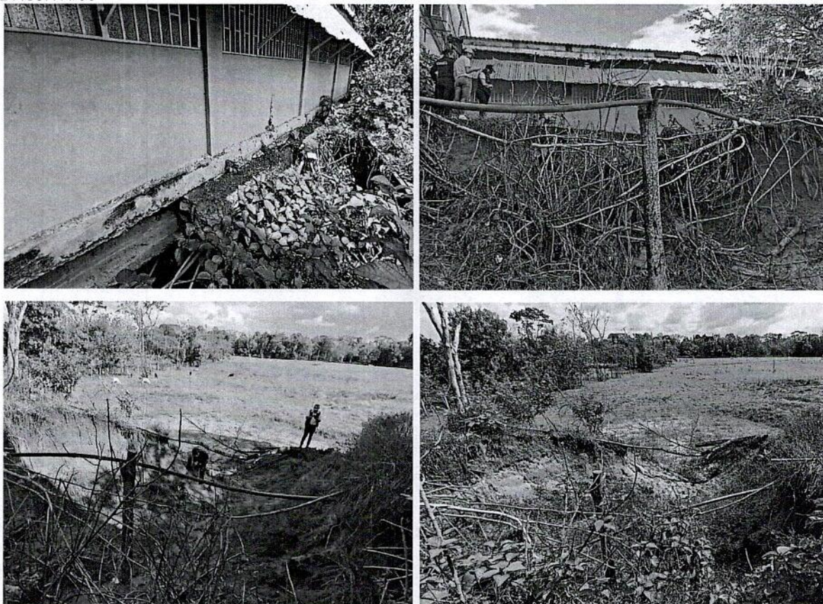
Imágenes. Registro fotográfico de la situación problemática en la cimentación del aula del colegio Alejandro Humboldt sede central.
