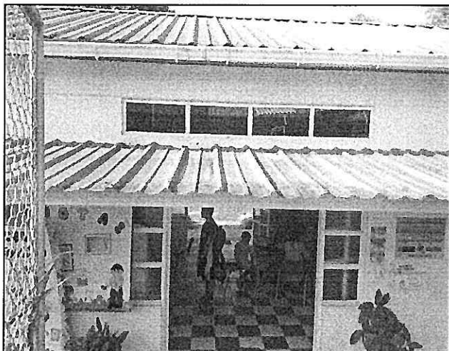
Ilustración 1. Estado de la cubierta de la biblioteca municipal
