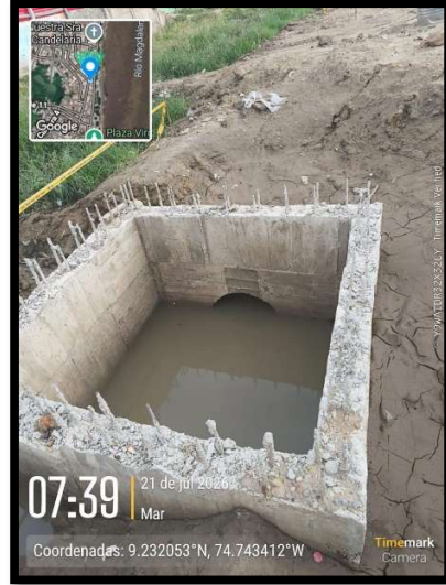
Ilustración 3. Fundida de Manhole de colector pluvial.
