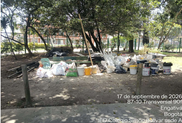
En area donde se intervino el cerramiento aun se encuentran herramientas y residuos de obra.
