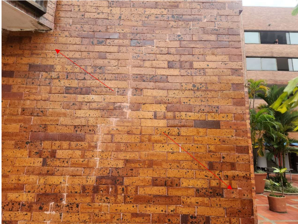
Ilustración 40. Asentamiento presentado en la edificación fachada .
