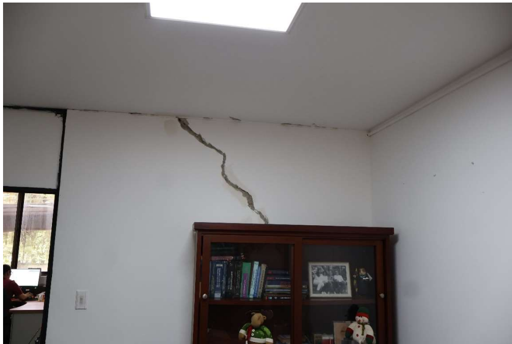
Ilustración 44. Lesión entre columnas por asentamiento.
