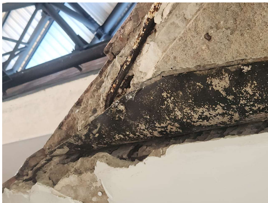
Ilustración 54. Desconchamiento por corrosión en armadura de viga.
