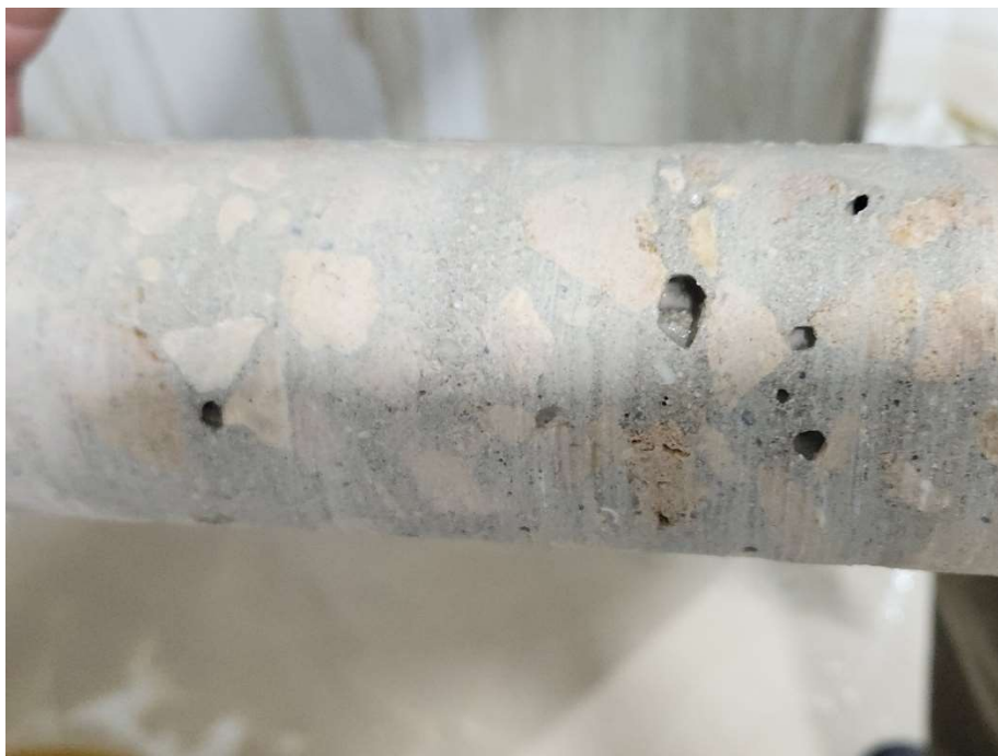
Ilustración 51. Porosidades y oquedades encontradas en la masa de concreto.
