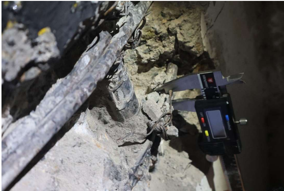
Ilustración 32. Estado del acero de refuerzo.
