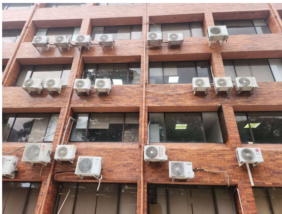
Ilustración 39. Presencia de elementos y equipos de aire acondicionado que generan un ataque por humedad en fachada .
