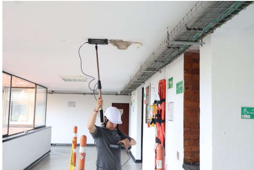
Ilustración 36. Procedimiento para detección de aceros de refuerzo con ferrosacan elementos entrepiso. (Fuente: Propia)
