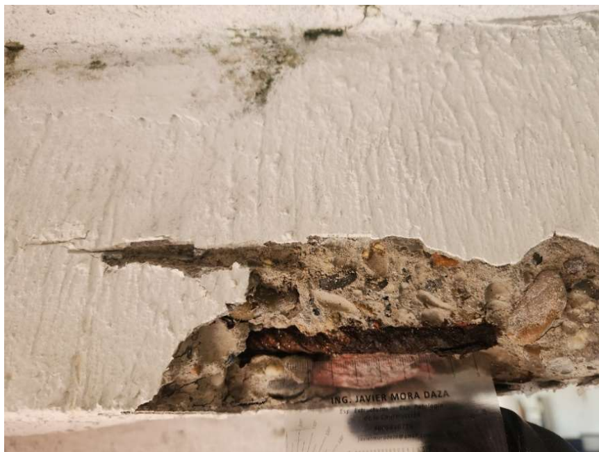
Ilustración 53. Ataque por corrosión.
