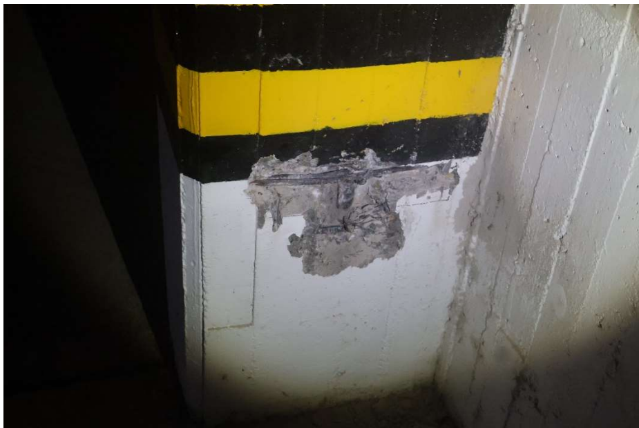
Ilustración 29. Procedimiento de Calas y/o Regatas para identificación de aceros de refuerzo. No se observan lesiones en el acero (Fuente: Propia)
