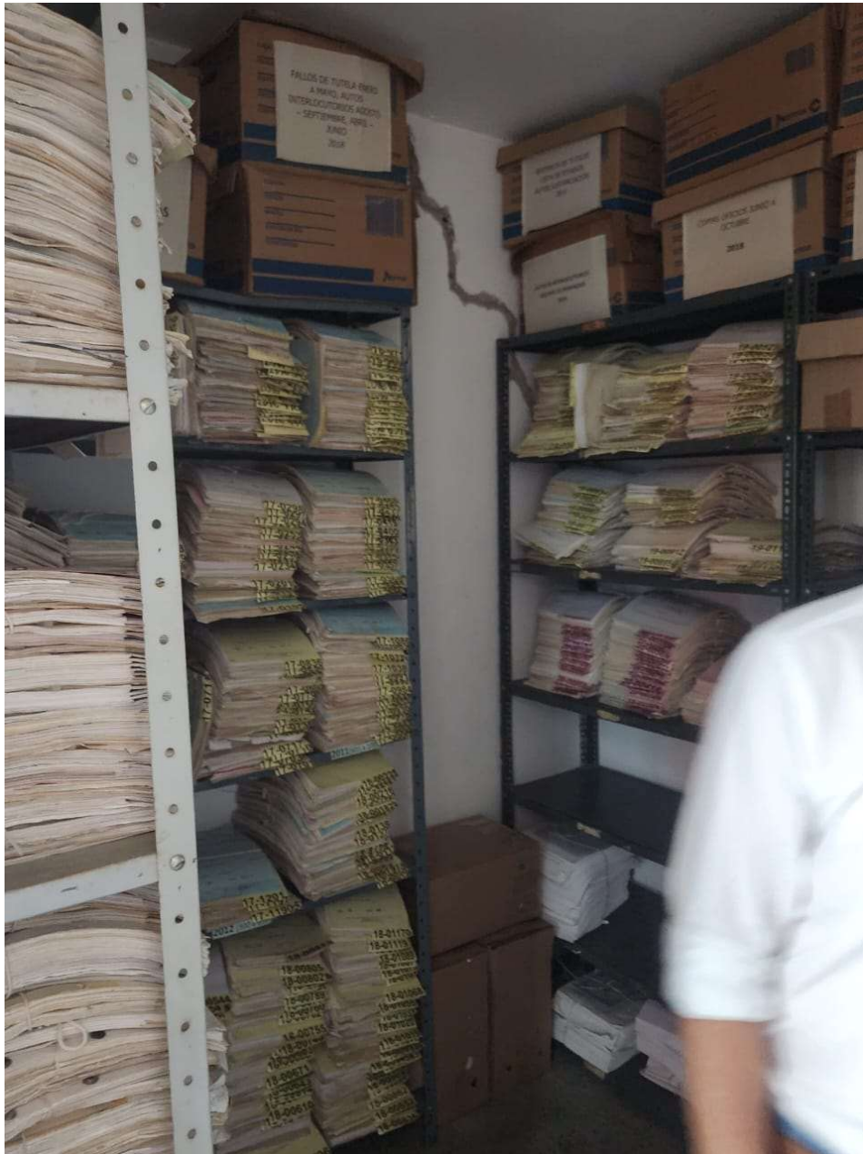
Ilustración 42. Sobrecarga viva generada por almacenamiento de procesos judiciales se observan lesiones en los elementos no estructurales posteriores..
