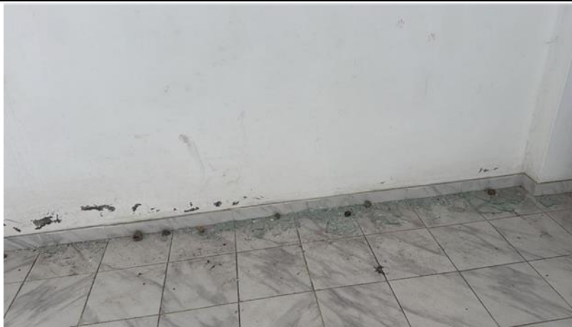
Ilustración 1. Imágenes de vandalismo en el establecimiento
