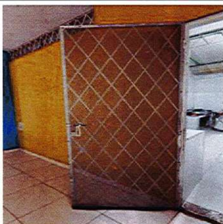
Puerta: malla antiinsectos de puerta de ingreso área de cocina, está rota.
