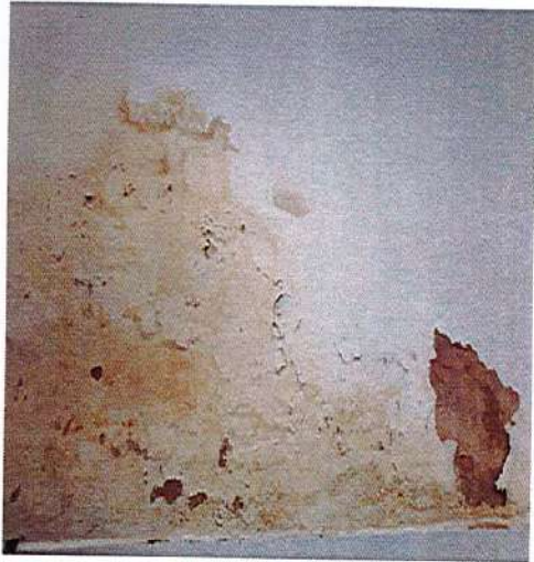
Paredes de comedor escolar presentan humedad.
