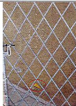
Hallazgo 4. Malla anti insectos de puerta de ingreso al área de cocina está rota
