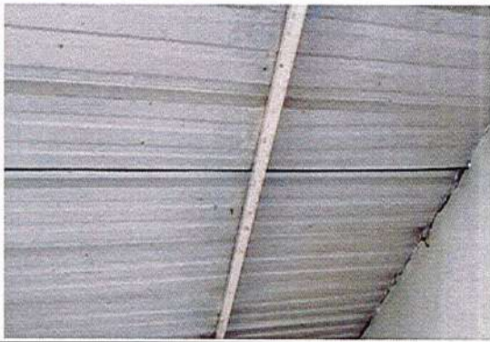
Techos con tubo metálico cuadrado expuesto, tejas en lámina muy altos, difícil limpieza.
