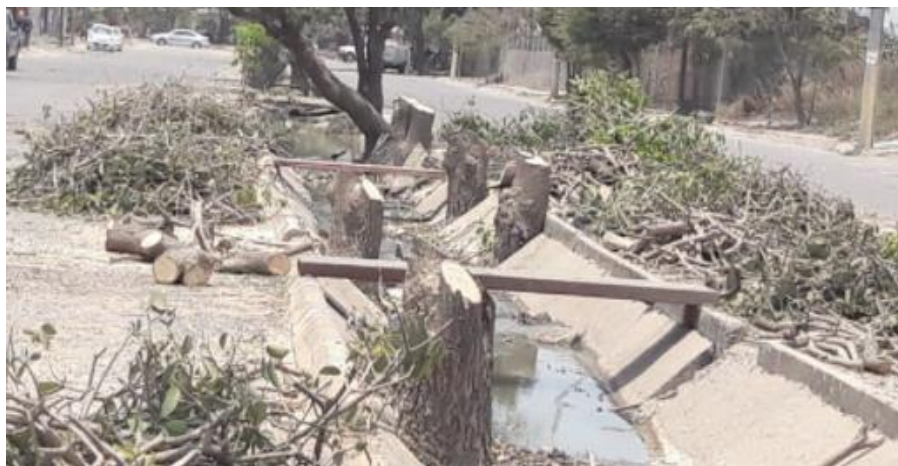
Figura 16. Afectaciones de árboles al alcantarillado
