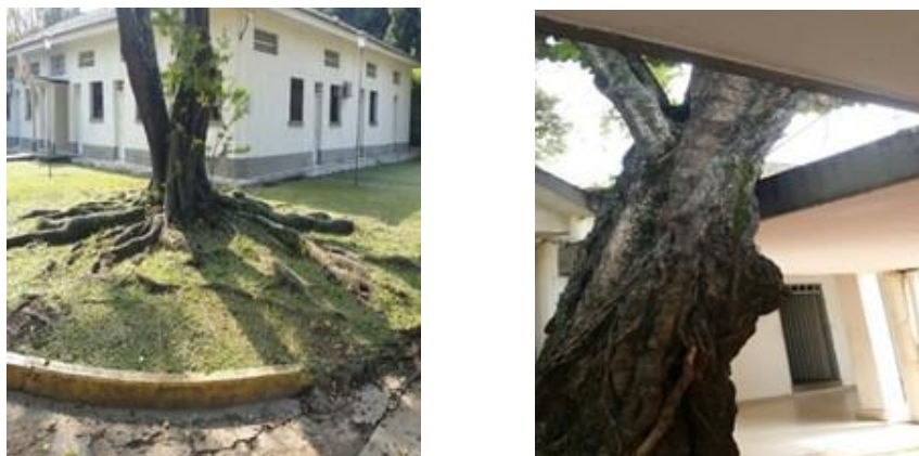
Figura 2. Árboles presentan daño en infraestructura
