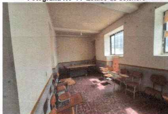
Fotografía No 9: Estado de deterioro acabados en muros.
