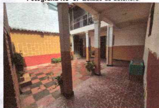
Fotografía No 10: Estado de deterioro, acabados de Muro
