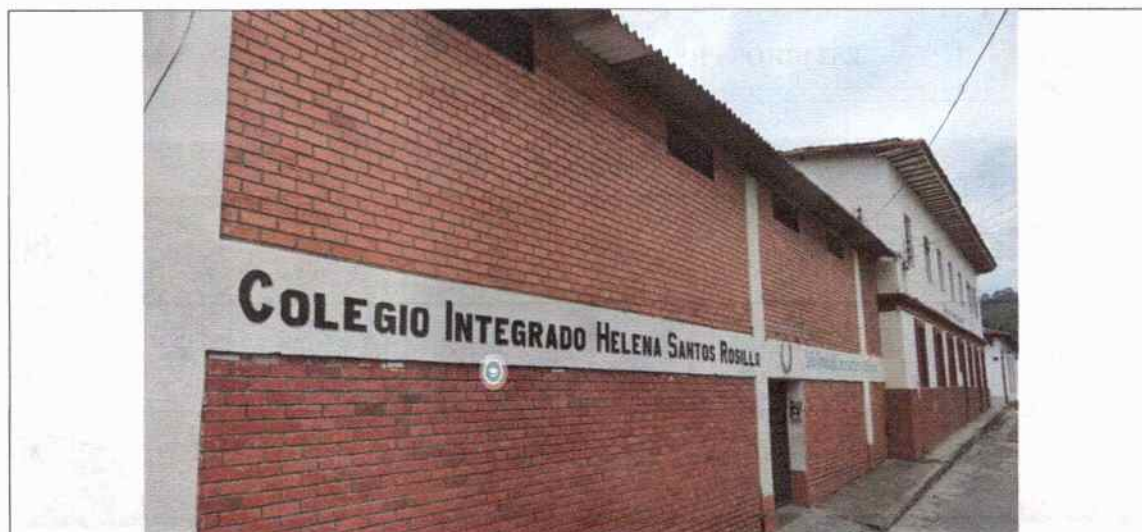
Fotografía No 5: Estado de deterioro acabados en muros.
