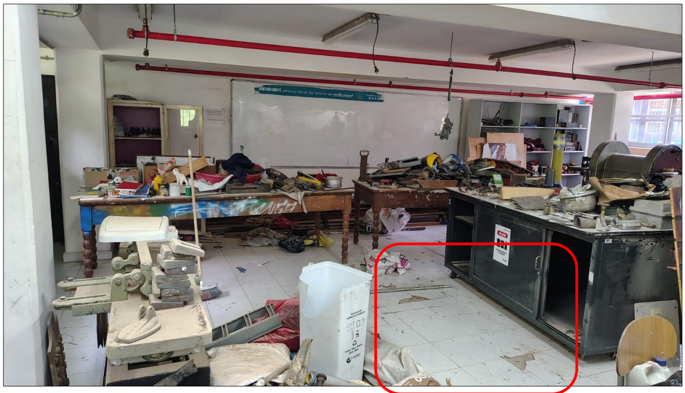
Fotografía 1. Acabado de piso levantado (primer nivel)
