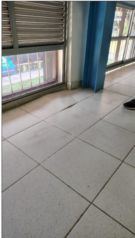
Fotografía 3. Acabado de piso levantado (segundo nivel)
