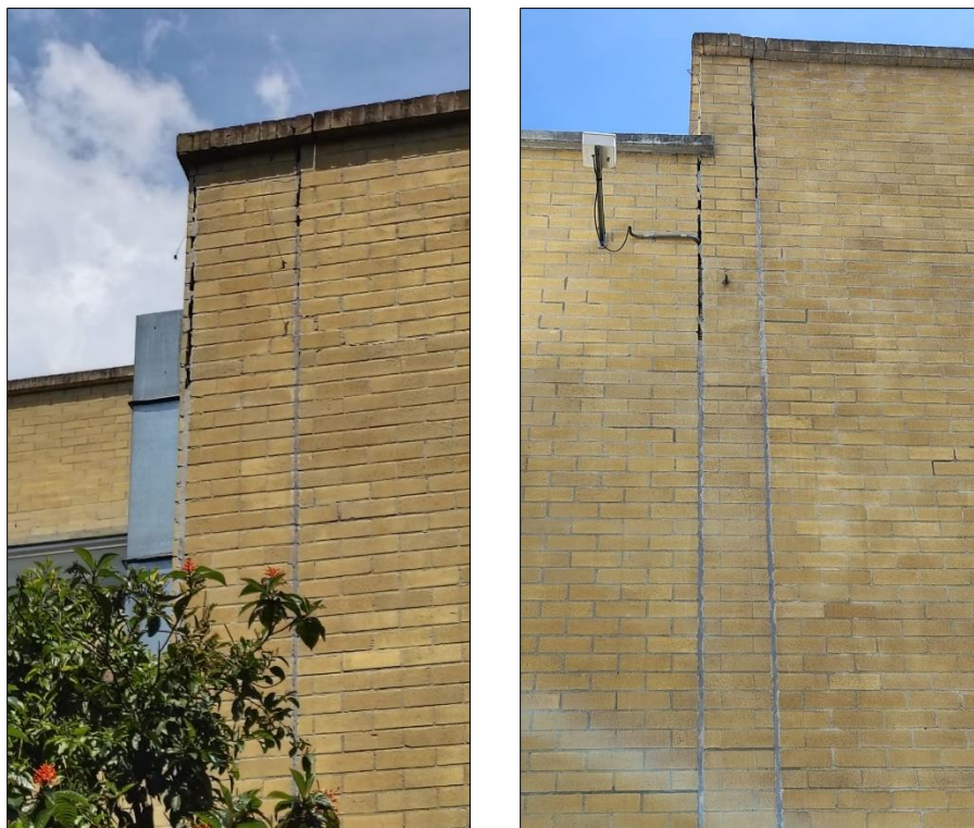
Fotografía 8. Desprendimiento de elementos de chapas en mampostería.
