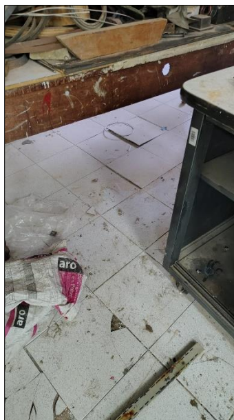
Fotografía 2. Acabado de piso con desprendimiento y levantados (primer nivel)
