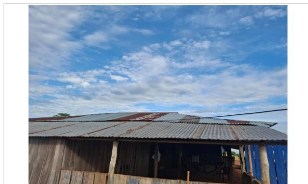
Fotografía 06. Cubierta de gran superficie conformada por láminas de diferentes estados y colores, asociadas a reparaciones y reposiciones parciales.
