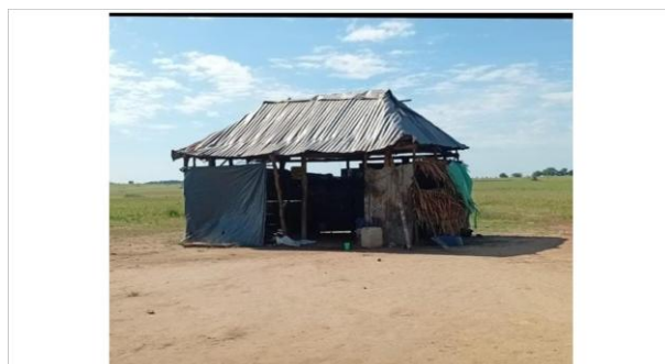
Fotografía 02. Unidad habitacional de alta precariedad, con láminas deformadas, pérdida de continuidad en la cubierta y cerramientos provisionales.
