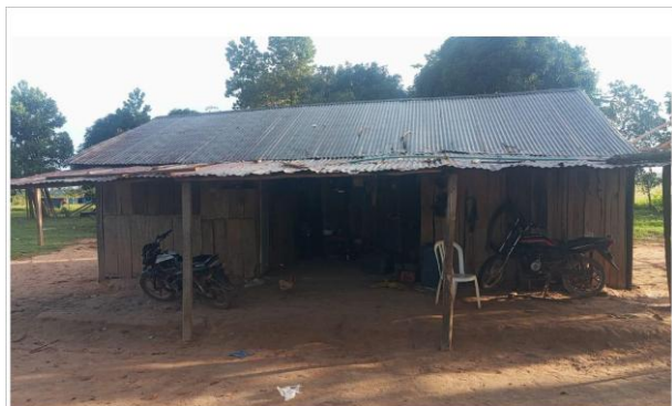
Fotografía 13. Vivienda con cubierta de gran superficie que presenta desgaste, irregularidades en el borde y paños con deterioro acumulado.
