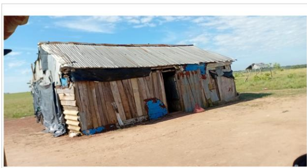
Fotografía 01. Vivienda con cerramientos de madera y materiales diversos; la cubierta presenta desgaste, reparaciones parciales y discontinuidades visibles.
