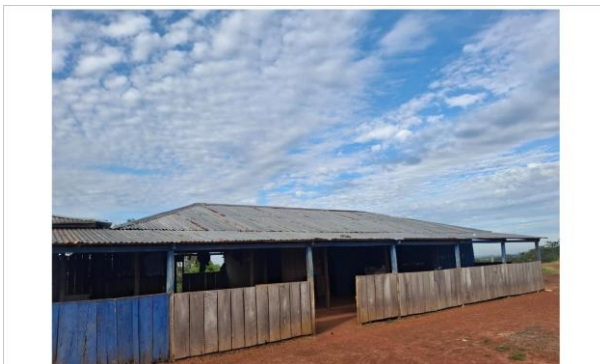
Fotografía 18. Edificación de mayor longitud con cubierta envejecida, sectores de desgaste y
