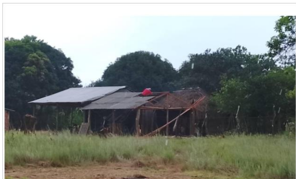
Fotografía 03. Construcción con cubierta incompleta y estructura expuesta, evidenciando condiciones limitadas de protección frente a la intemperie.
