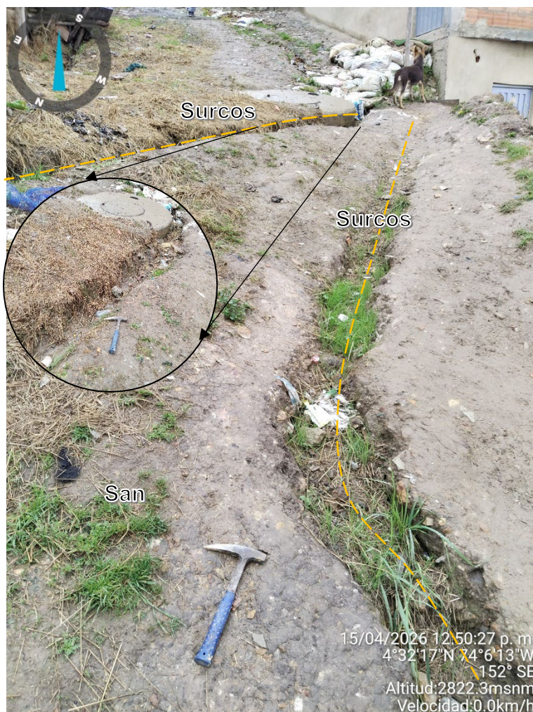
Figura 3-32 Surcos generados por escorrentías
