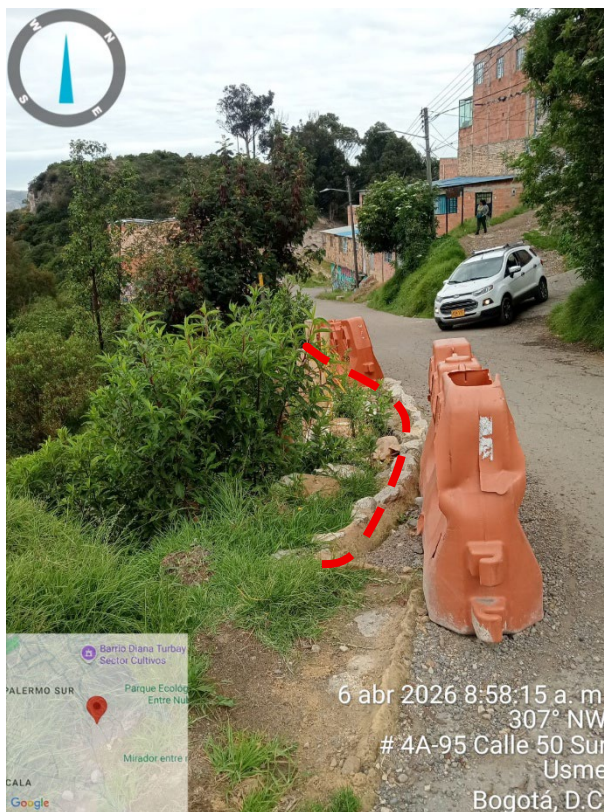
Figura 3-53 Deslizamiento rotacional polígono 1
