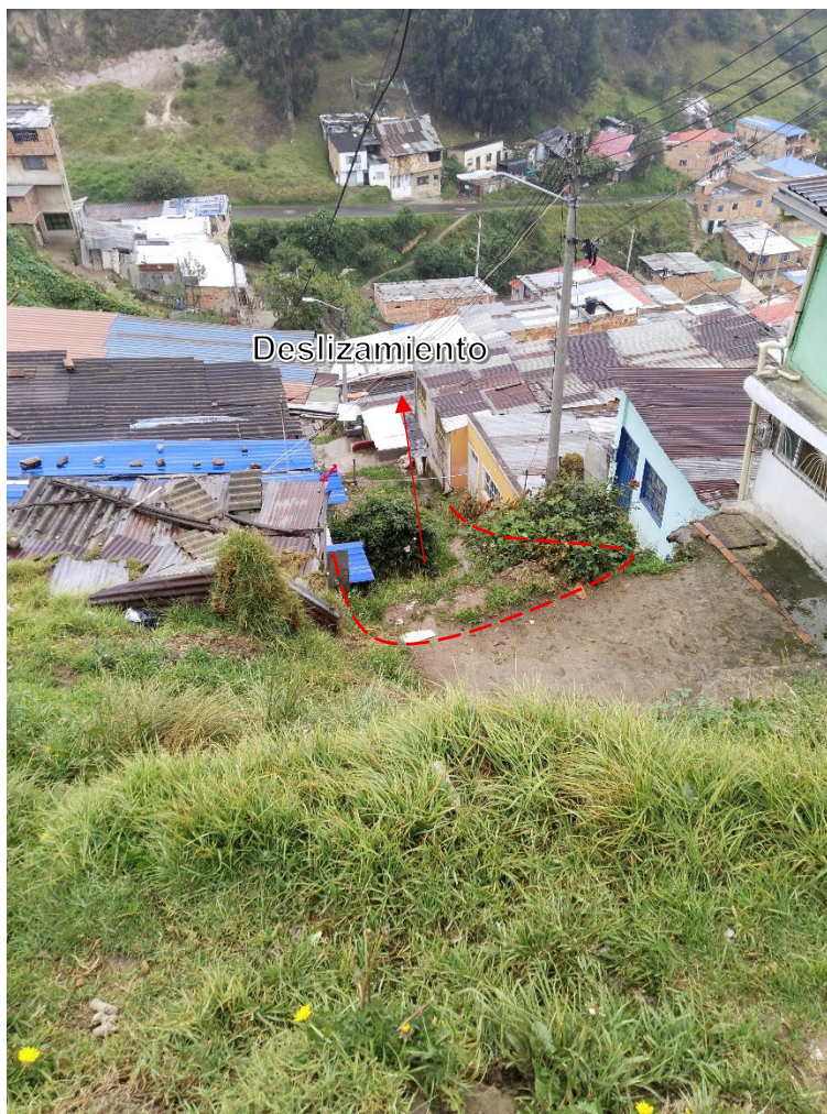
Figura 3-24 Foto desde arriba deslizamiento
