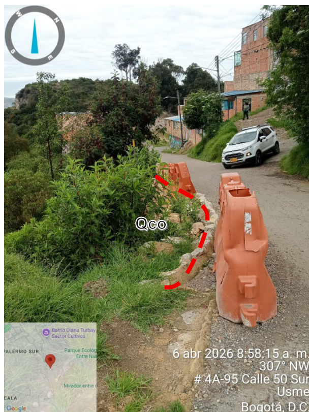
Figura 3-33 Deslizamiento rotacional polígono 1
