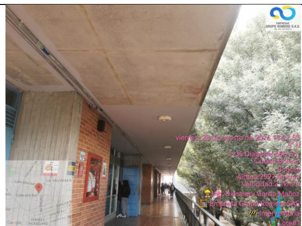
Pintura bajo placa en pasillo de bloques morado.
