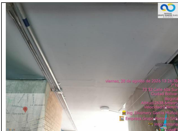
Pintura bajo placa en pasillo de bloques azul.
