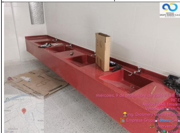
Suministro de divisiones en acero inoxidable
