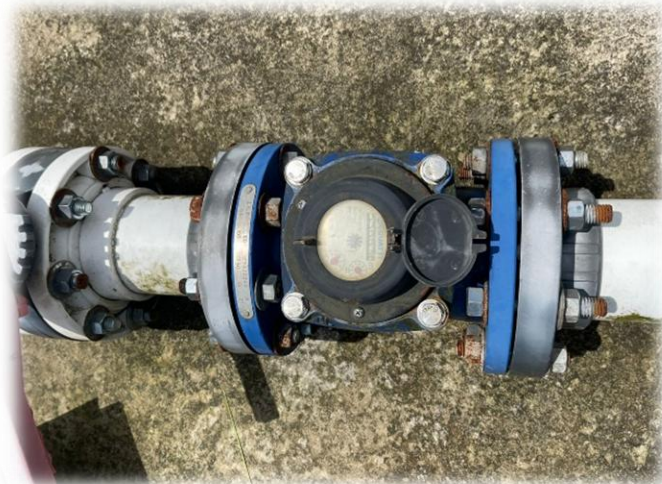
Macromedidor de 4" tanques de almacenamiento sector Villa Paz
