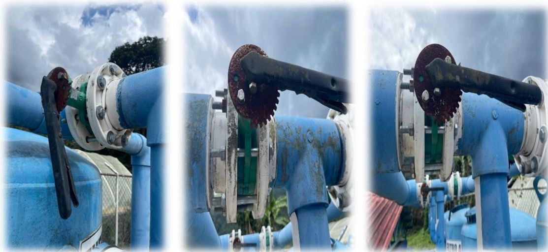
Registros mariposas de 4" filtros compactos planta PTAP
