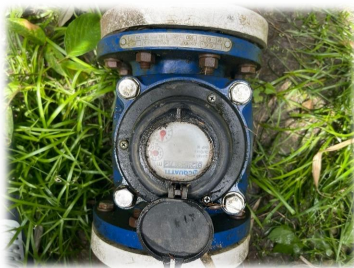
Macromedidor de 4" salida tanques de almacenamiento PTAP
