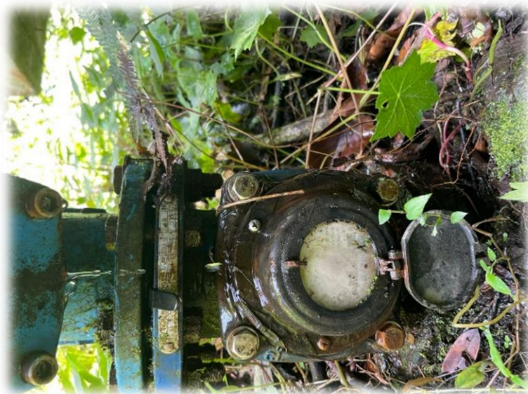
Macromedidor de 4" salida desarenador pequeño sector bocatoma
