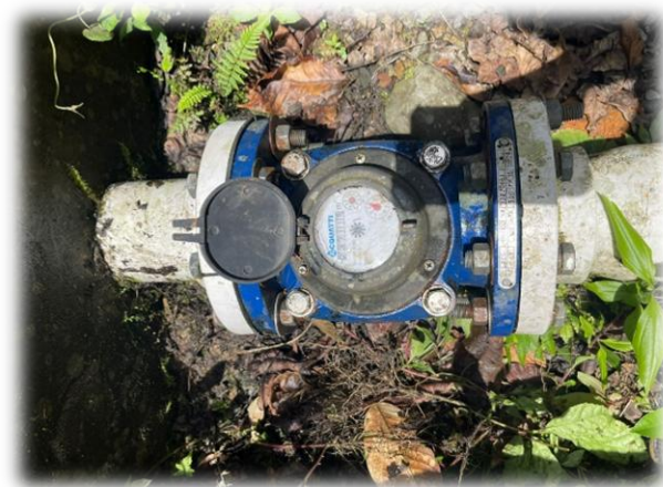
Macromedidor de 4" salida de desarenador grande sector bocatoma
