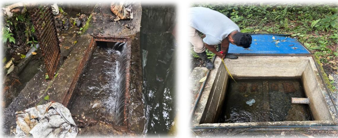
Rejilla y cámara derivación PTAP
