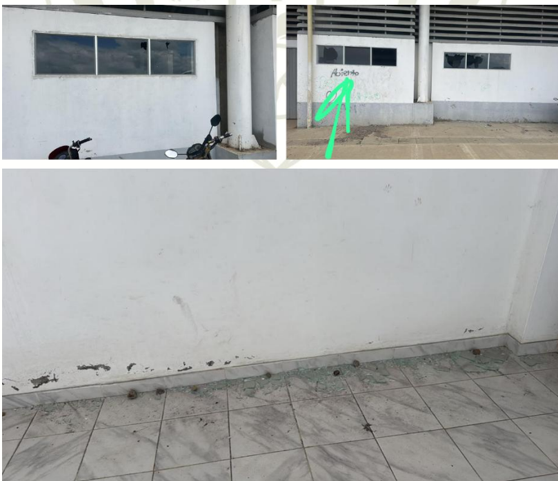
Ilustración 1. Imágenes de vandalismo en el establecimiento
