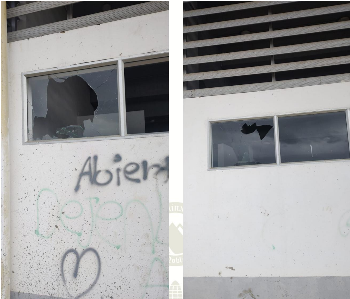
Ilustración 2. Imágenes de vandalismo en el establecimiento
