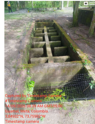
Fotografía 2. Tanque de contacto
