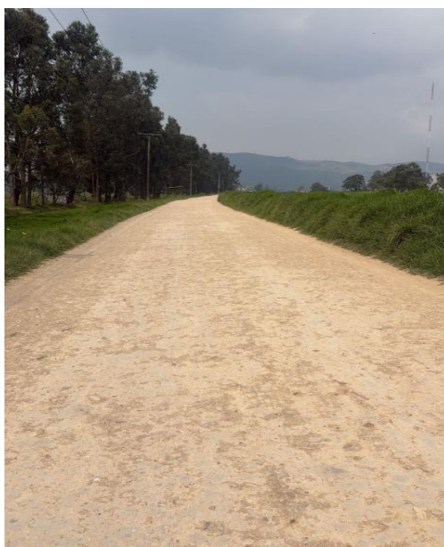
Imagen No. 18. Estado tramo doce. Fuente: Propia.
