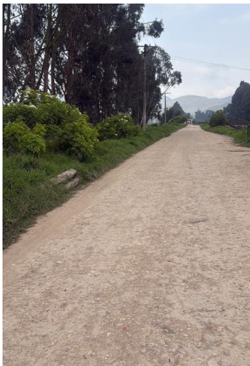
Imagen No. 14. Estado tramo ocho. Fuente: Propia.
