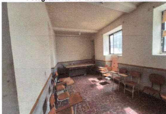
Fotografía No 9: Estado de deterioro acabados en muros.
