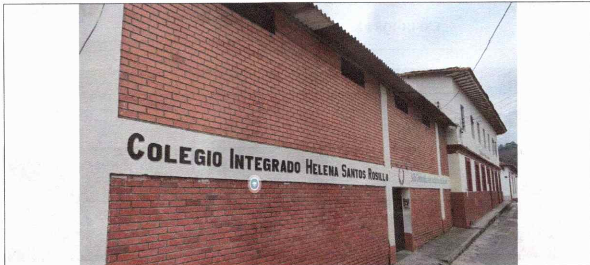
Fotografía No 5: Estado de deterioro acabados en muros.
