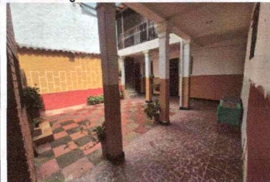
Fotografía No 10: Estado de deterioro, acabados de Muro
