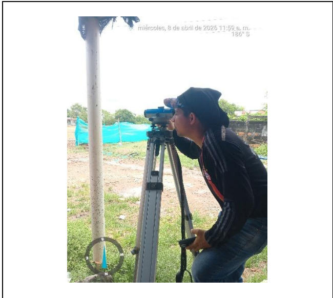
Control de niveles
