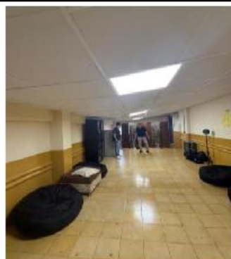
FOTO No 10 CIELO RASO AULA IE EUGENIO PACELLI SEDE PRINCIPAL
