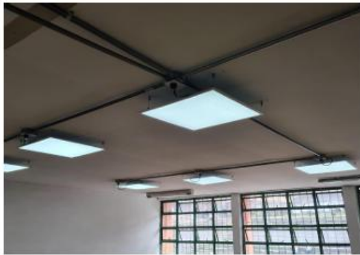
FOTO No 1 INSTALACIONES ELECTRICAS AULAS IE MALHABAR SEDE A - JOSÉ RUFINO
