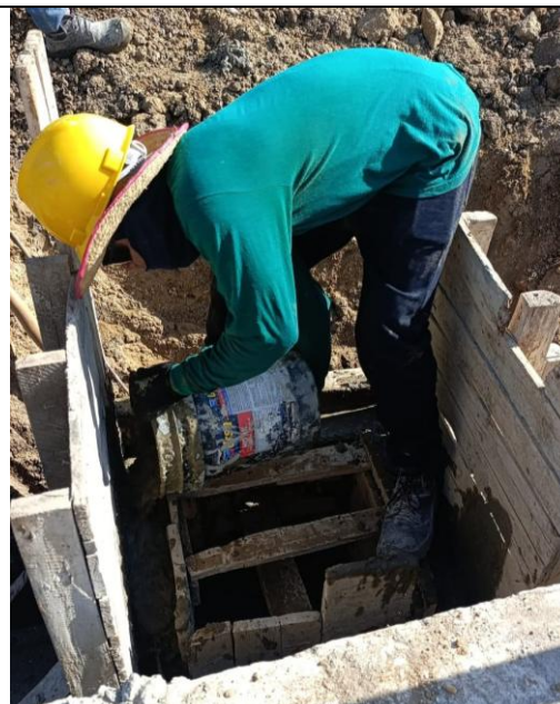
Registro drenaje exterior cancha
