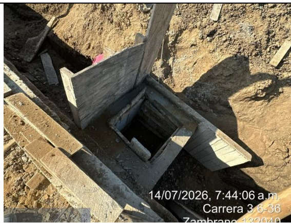
Registro drenaje exterior cancha
