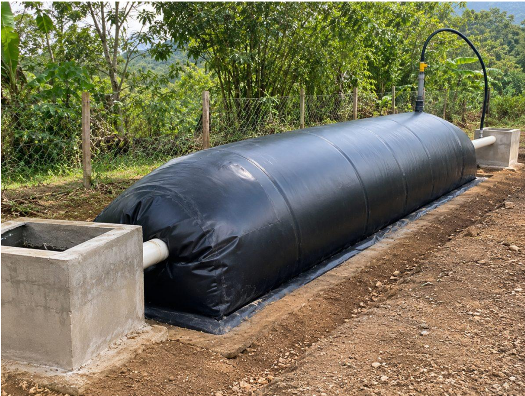
Figura. Imagen ilustrativa de un biodigestor tubular flexible con conexiones de entrada, salida y conducción de biogás.
