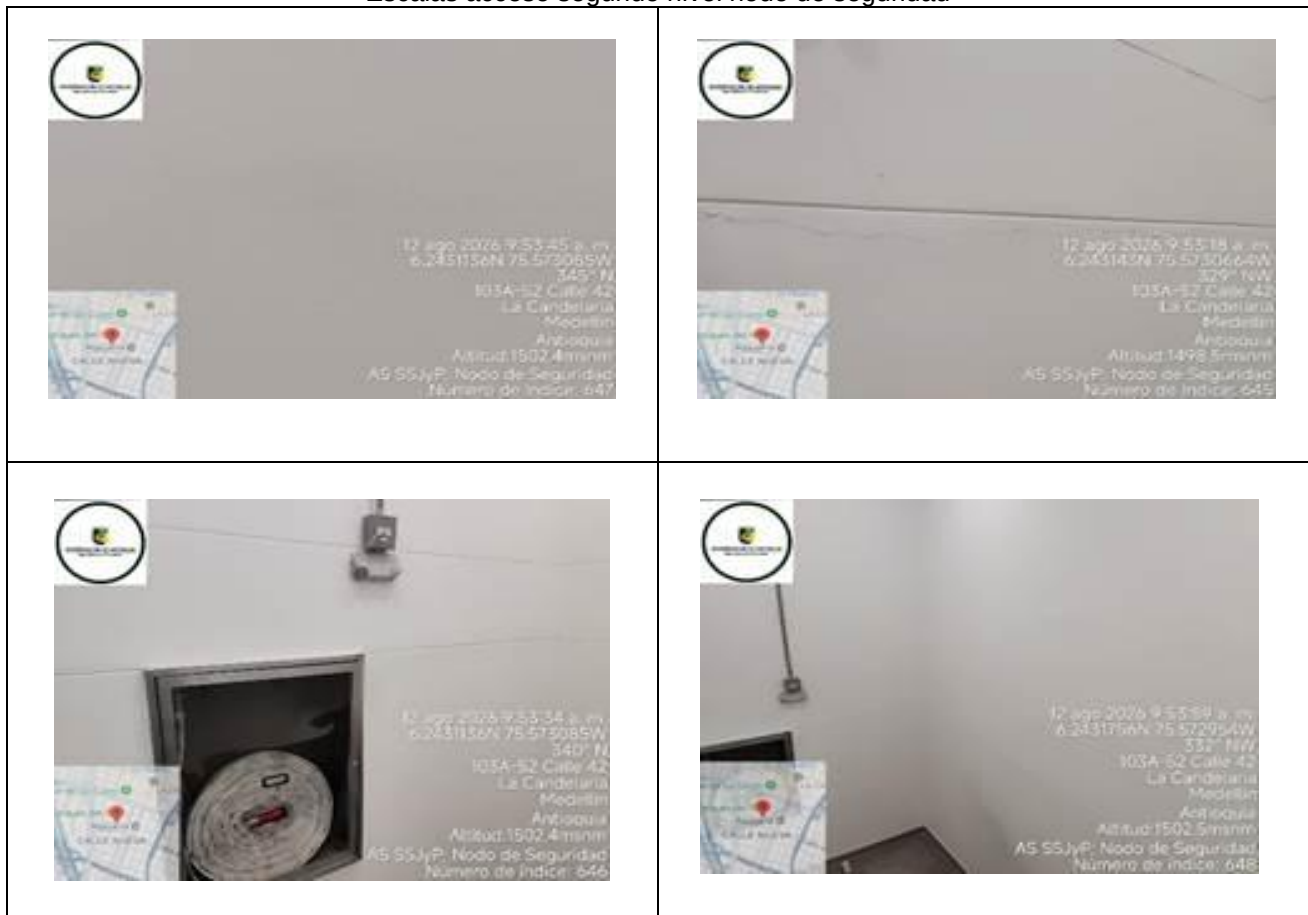
Escalas acceso segundo nivel nodo de seguridad
