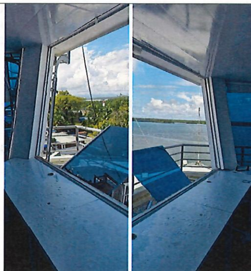
Ilustración 7 caída de vidrios
