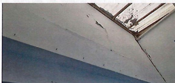
Ilustración 11 separación del pórtico de ingreso con el resto de la estructura
