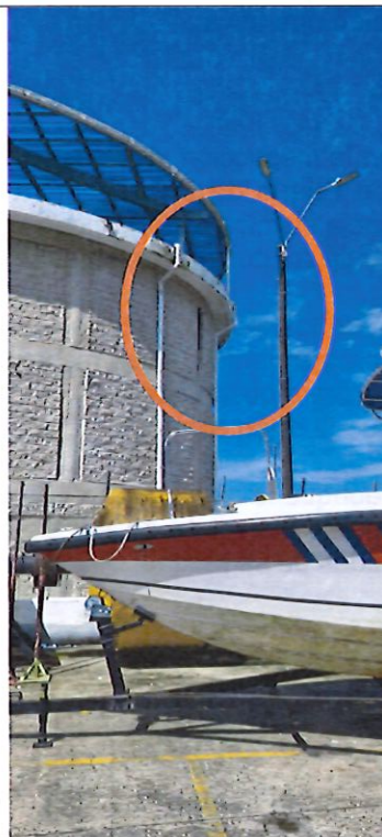
Ilustración 3 muro con evidencia de desprendimiento en la parte superior
