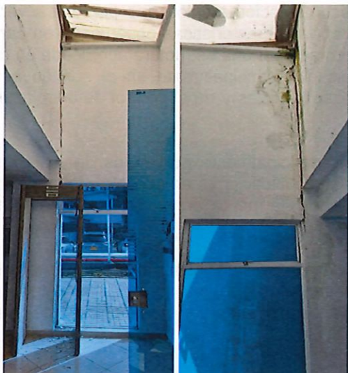
Ilustración 10 separación del pórtico de ingreso con el resto de la estructura
