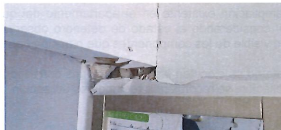
Ilustración 113 vista interior ampliación, detalle de apoyos deteriorados
