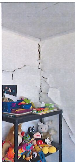
Ilustración 112 vista interior ampliación, detalle de apoyos deteriorados
