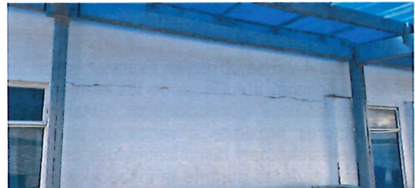
Ilustración 9 fisura horizontal en recubrimiento en puntos débiles pro presencias vanos
