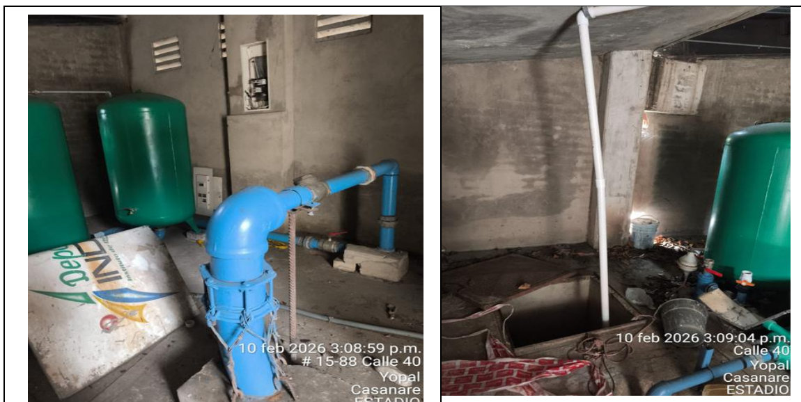
Foto 7-8 Se evidencia deterioro en el sistema hidráulico del cuarto de máquinas de bombeo, con presencia de fugas y escapes de agua en tuberías, conexiones y accesorios, lo cual genera humedad y acumulación de agua en el área.
