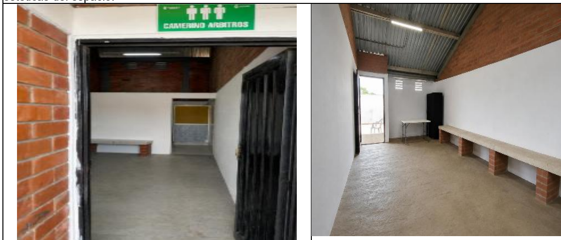
Foto 15-16. El espacio presenta condiciones funcionales básicas; sin embargo, requiere actividades de mantenimiento y adecuación de acabados, pisos, pintura, iluminación y elementos complementarios, con el fin de garantizar condiciones apropiadas de uso, comodidad, seguridad y conservación para los usuarios.
