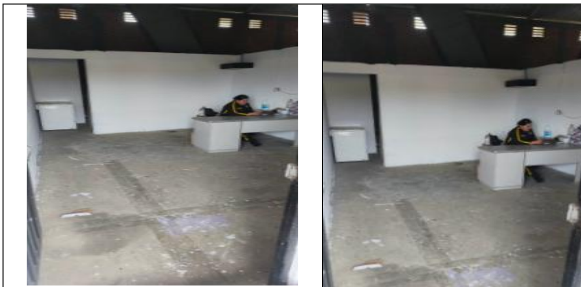
Foto 13-14. Cuarto del emisario se evidencia que las paredes cuentan con acabado en pintura, con necesidad de mantenimiento para mejorar las condiciones de conservación y presentación del área.
