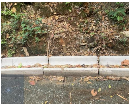
FALTA DE EMBOQUILLADO ENTRE PREFABRICADOS DE CUNETA
