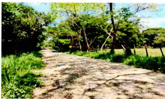
ESTADO ACTUAL DE LA VÍA TRAMO DE INTERVENCIÓN
