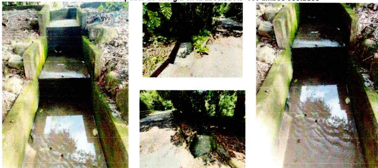
Ilustración 5 Disipador de energía en la abscisa K0+000 ambos costados
