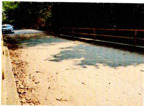
Fotografía N°1 : Vista del tablero
