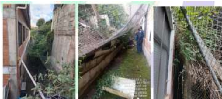
Figura 2, 3 y 4: Deformación e inclinación progresiva del cerramiento localizado en el límite posterior de la Institución Educativa Marco Tobón Mejía, evidenciándose desplazamiento gradual del talud hacia las instalaciones educativas y pérdida de estabilidad del sistema de cerramiento respecto a las condiciones inicialmente observadas en el año 2024.
