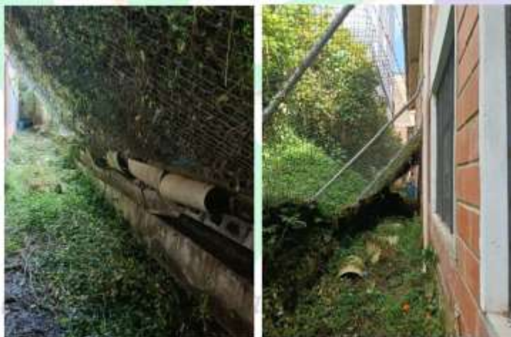
Figuras 11 y 12: Condiciones actuales de humedad, acumulación vegetal y deterioro del corredor posterior de la Institución Educativa Marco Tobón Mejía.
