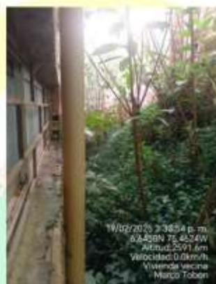
Figura 5: Cobertura vegetal abundante y condiciones de humedad permanente sobre la ladera colindante con la Institución Educativa Marco Tobón Mejía.
