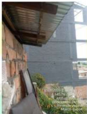
Figuras 8: Vivienda colindante ubicada en la parte superior de la ladera, donde se evidencia ausencia de sistemas adecuados de recolección y conducción de aguas lluvias, tales como canoas y bajantes, situación que puede favorecer el vertimiento directo e infiltración de aguas sobre el talud posterior de la Institución Educativa Marco Tobón Mejía.
