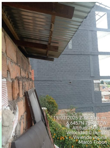
Figuras 8: Vivienda colindante ubicada en la parte superior de la ladera, donde se evidencia ausencia de sistemas adecuados de recolección y conducción de aguas lluvias, tales como canoas y bajantes, situación que puede favorecer el vertimiento directo e infiltración de aguas sobre el talud posterior de la Institución Educativa Marco Tobón Mejía.
