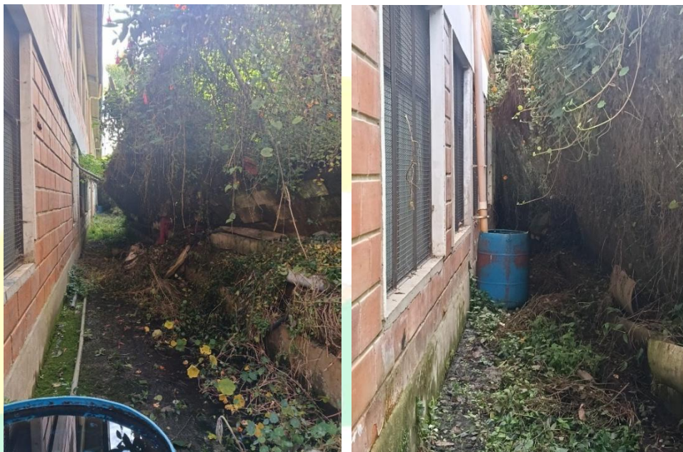
Figuras 9 y 10: Deformación e inclinación progresiva del cerramiento colindante con la ladera posterior de la institución educativa.
