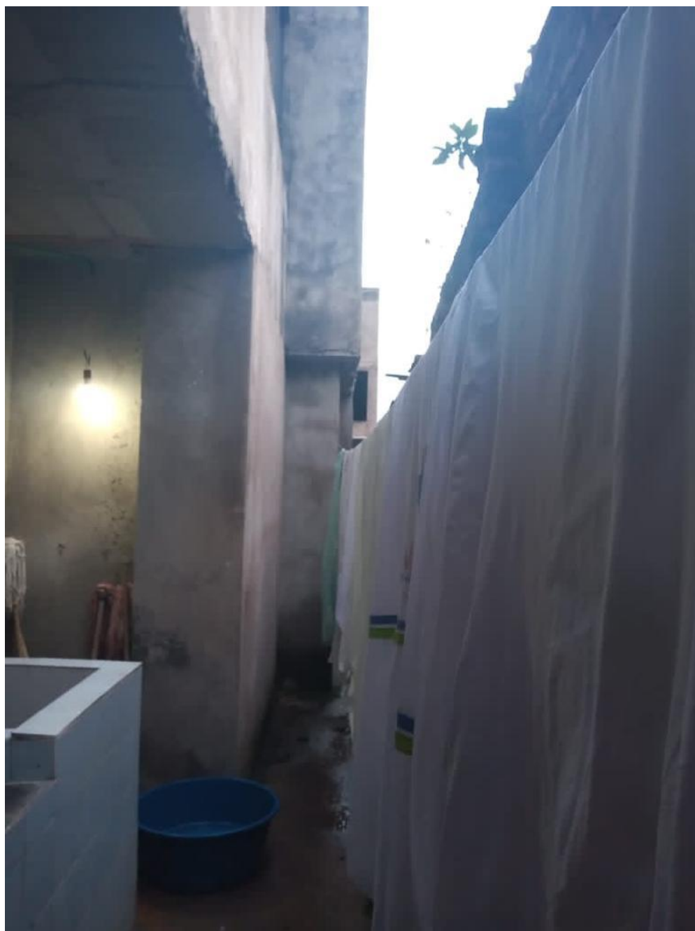
Imágenes 3-9. ESTADO ACTUAL HOSPITAL JOSE ANTONIO SOCARRAS
