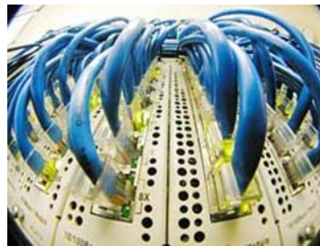
Paneles de parcheo (patch panel)
