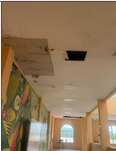
Ilustración 14 Cielo falso en pasillo con deterioro por humedad
