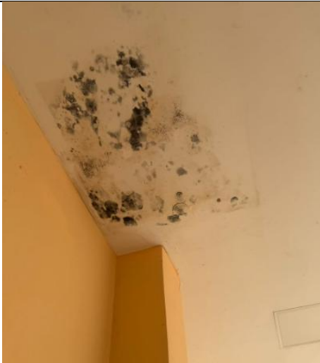
Ilustración 12 presencia de moho por humedad
