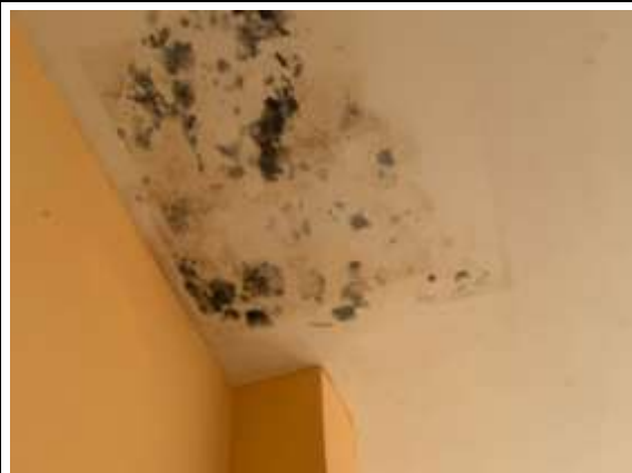
Figura 15. Piso 2 – presencia de moho por humedad
