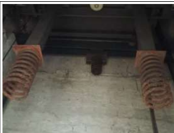
Figura 28. Ascensor – amortiguadores (buffers) del foso con oxidación avanzada
