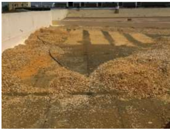
Figura 10. Cubierta – manto asfáltico con desgaste superficial
