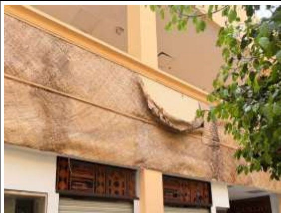
Figura 20. Zona de escaleras – desprendimiento del revestimiento en estera
