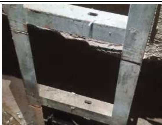
Figura 29. Ascensor – bastidor del contrapeso con corrosión
