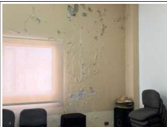
Figura 16. Oficinas piso 2 – desprendimiento de pintura y acabados por humedad
