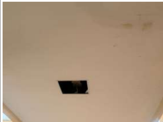
Figura 13. Pasillo piso 2 – cielo falso deteriorado
