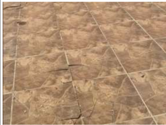
Figura 11. Cubierta – enchape cerámico fisurado
