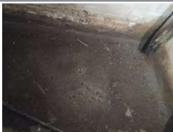
Figura 27. Ascensor – humedad y sedimentos en foso
