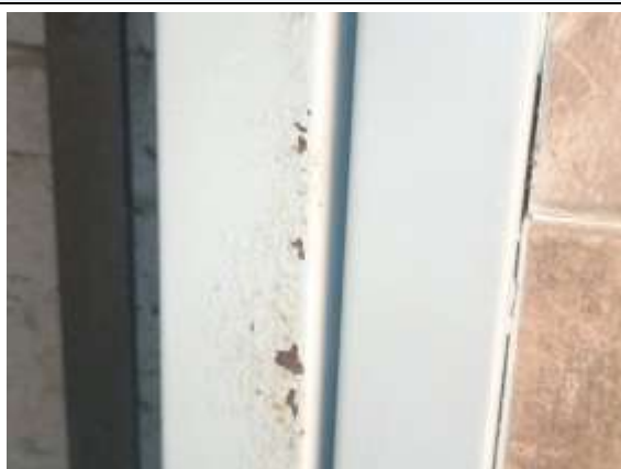
Figura 26. Ascensor – corrosión en marco de puerta de piso
