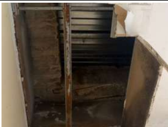
Figura 14. Auditorio Princesa Onomá – afectación por filtraciones
