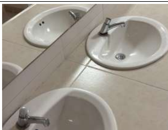
Figura 23. Baños – push de control de lavamanos en mal estado
