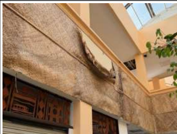
Figura 18. Balcón piso 2 – desprendimiento del revestimiento en estera del antepecho
