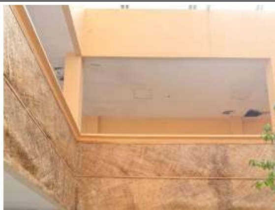
Figura 19. Balcón piso 2 – revestimiento en estera con manchas de humedad y desprendimiento
