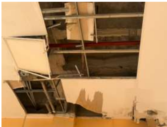
Figura 12. Pasillo piso 2 – desprendimiento de cielo falso
