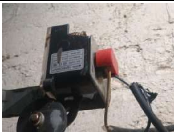
Figura 30. Ascensor – micro de final de carrera con indicios de afectación
