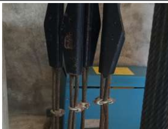
Figura 31. Ascensor – amarres y sujeción de cables de tracción
