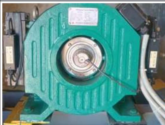
Figura 32. Ascensor – máquina de tracción en cuarto de máquinas
