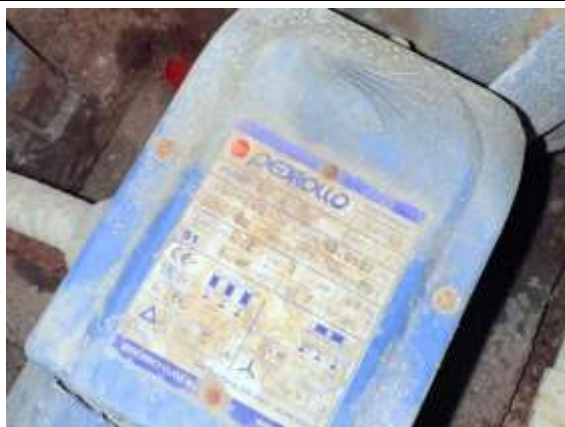
Figura 24. Bomba de agua potable fuera de servicio
