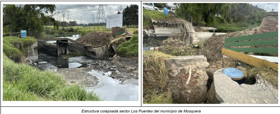
Estructura colapsada sector Los Puentes del municipio de Mosquera
