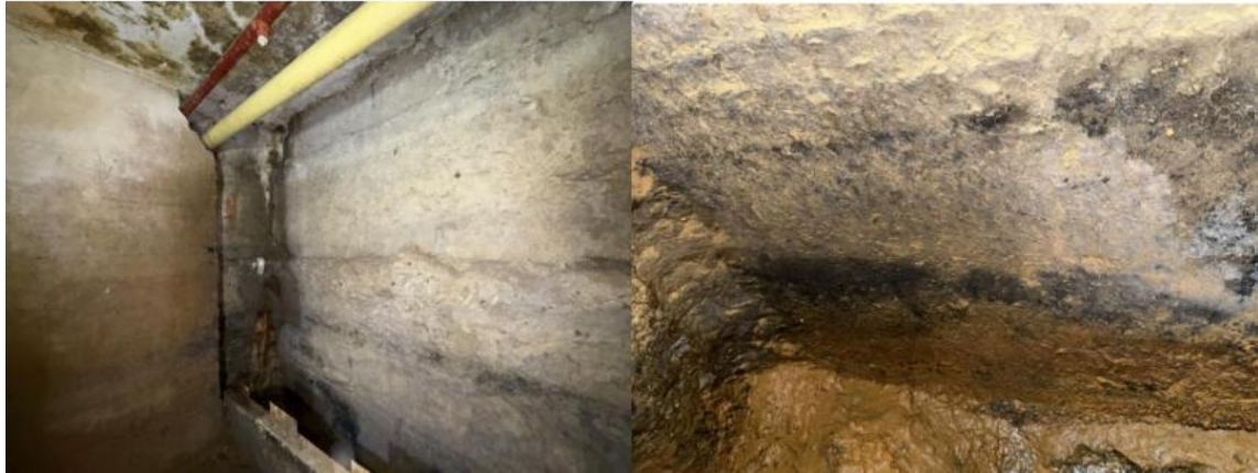
Foto No. 9 - Evidencia fotográfica de filtraciones. Fuente: TIBOCOR.
