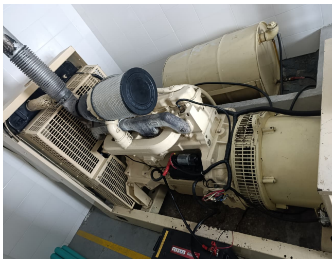
Panorámica planta eléctrica
